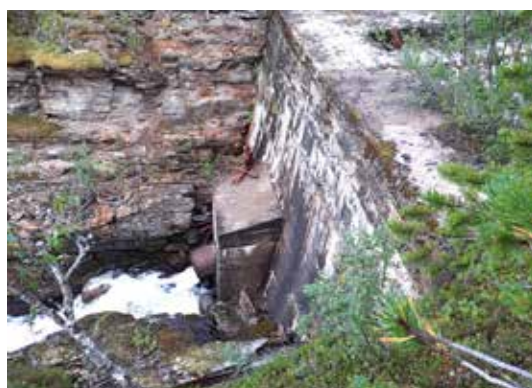
Dammen i dag, vær oppmerksom på manglende sikring langs den 14 m høye damkanten. Foto: Aina Heimdal
